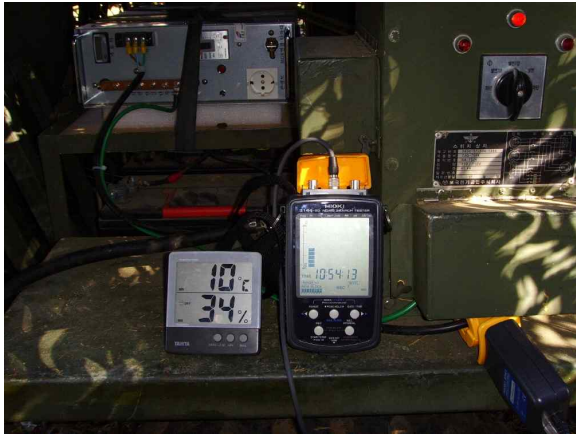
eca3G 설치 후 노이즈 측정(양호)
