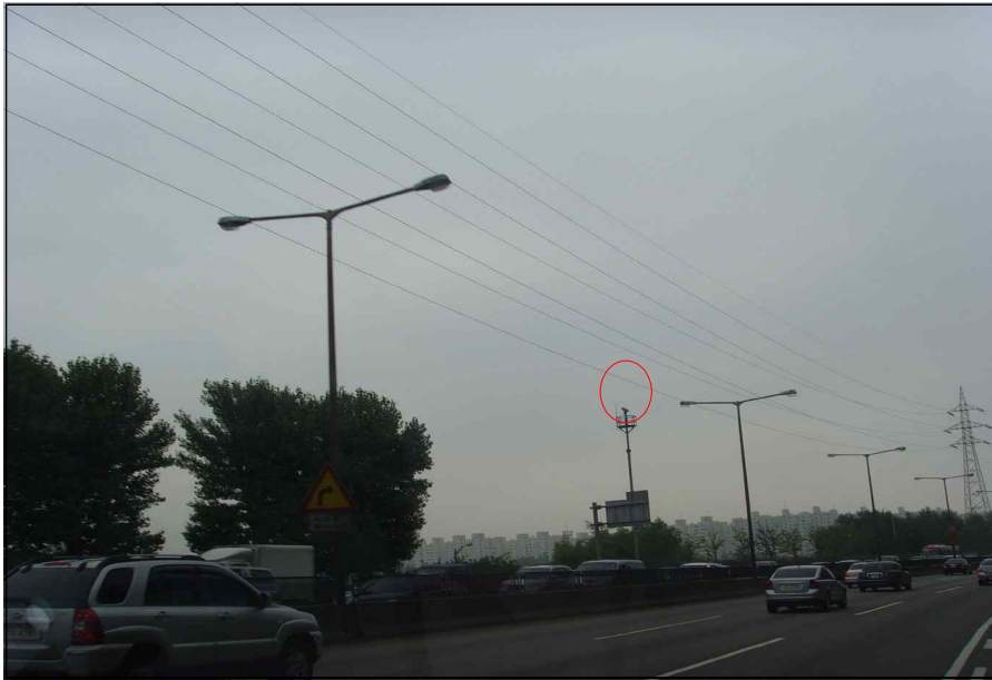
그림-9 수서-분당 간 도로, 고압송전선 밑에 몰아내는 피뢰침? 직격낙뢰는 절대 못 온다.
