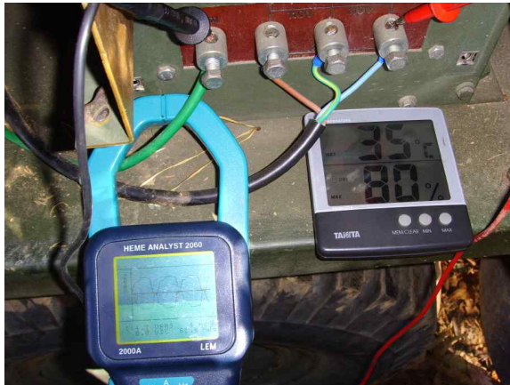
eca3G 설치 후 전력품질 측정(양호)
