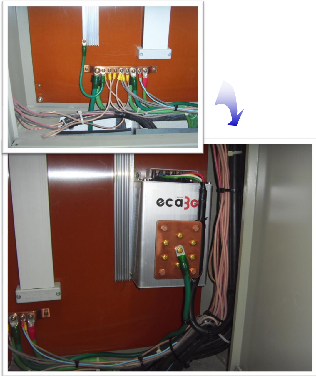
100KW 분전반 LP설치
