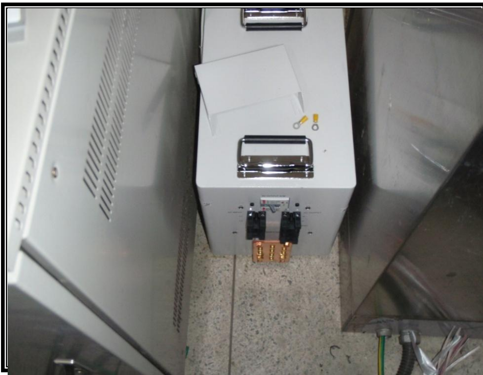
TNC2 설치 후(UPS 2차)
