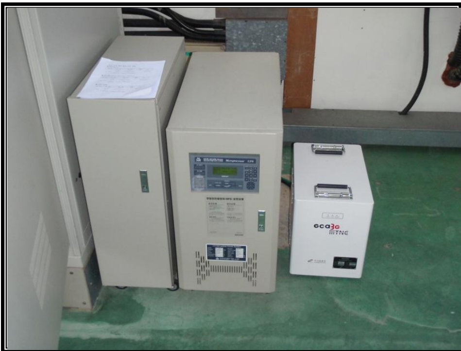
TNC2 설치 후 (UPS2차)
